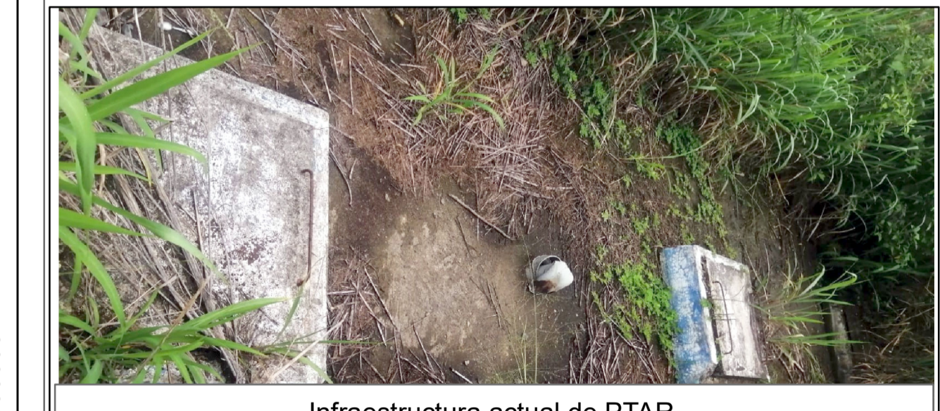
Infraestructura actual de PTAR
