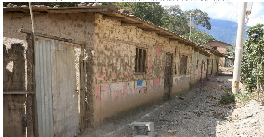
FOTOGRAFIA N° 2.6-10 Vivienda en mal estado de conservación
