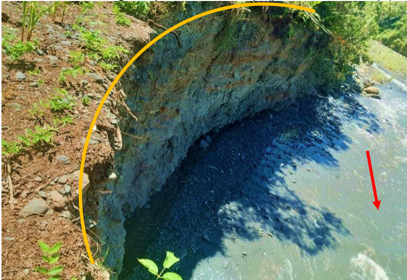
FOTOGRAFIA N° 2.5-14 Erosión fluvial lateral (entre 2.5 a 3 m. de ancho) y escarpe de derrumbe del talud, originado por el río Chancamayo (planicie de Chancamayo).
