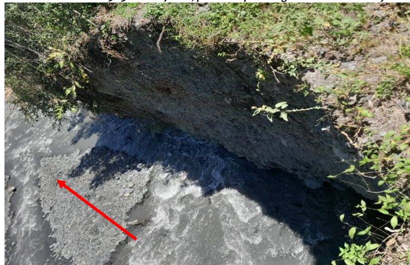
FOTOGRAFIA N° 2.5-13 Erosión fluvial, producida por las aguas del río Chancamayo.
