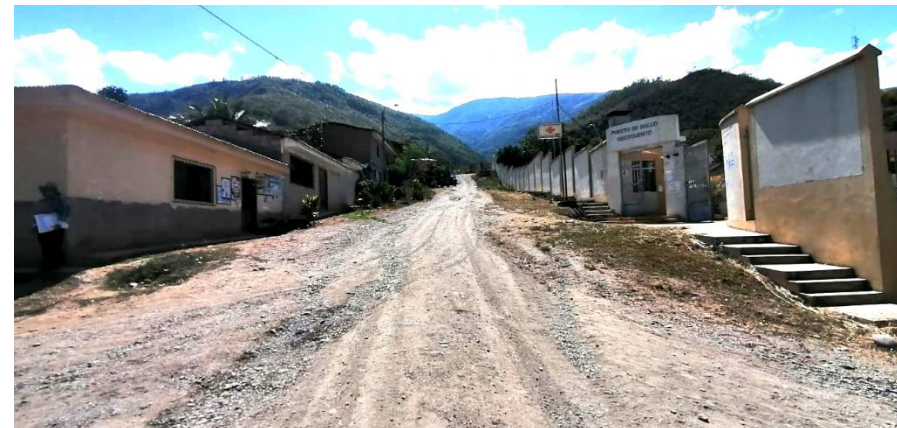
FOTOGRAFIA N° 2.6-27 Estado de conservación Malo
