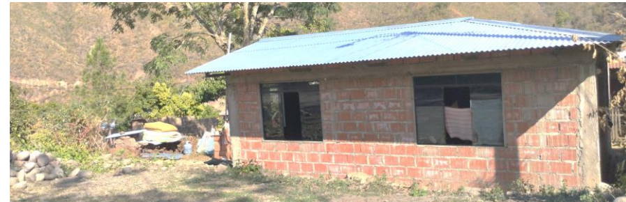
FOTOGRAFIA N° 2.6-21 Estado de conservación Malo
