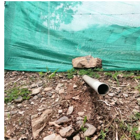
FOTOGRAFIA N° 2.6-53 Lotes sin Cobertura de Alcantarillado
