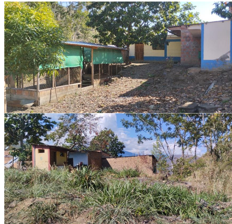
Imagen 1 y 2: Viviendas conformadas por dos bloques y una letrina de SSHH Lote 6 de la Manzana 11 y Lote 15 de la Manzana 13
