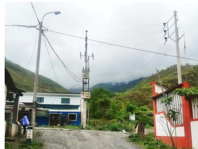
FOTOGRAFIA N° 2.6-55 Alumbrado público y Red de Media Tensión del CP Quesquento
