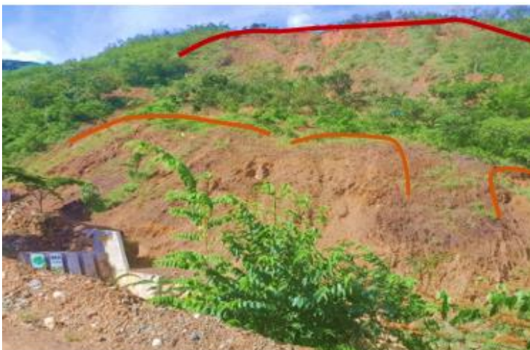
FOTOGRAFÍA N° 2.5-20: Movimiento mixto; en la parte alta se observa escarpe de un deslizamiento de más de 100m de largo y hacia la base, derrumbes provocados por la erosión del río Quellomayo, en el fondo de la quebrada disipadores de energía hidráulica con estructura denta
