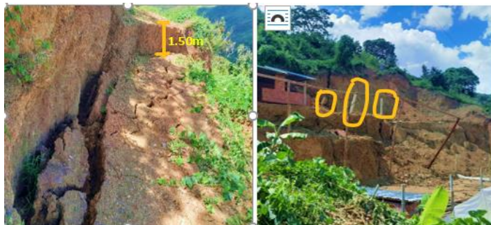
FOTOGRAFÍA N° 2.5-26: Escarpe y grietas de un deslizamiento activo y Fisuras y columnas de concreto inclinadas.
