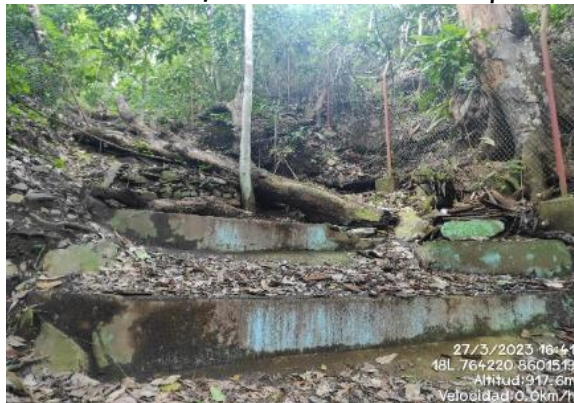
FOTOGRAFÍA N° 2.4-11: Manantial Ebenecer – Captación
