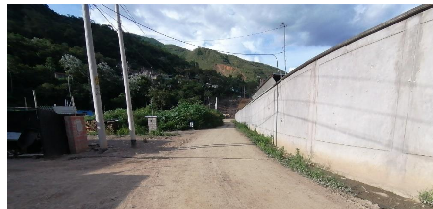
FOTOGRAFÍA N° 2.6-29: Estado De Conservación de vías
