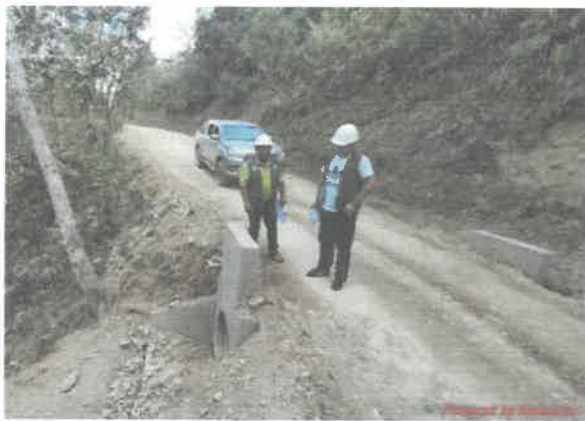
Reposición de obras de arte (Alcantarilla) y rehabilitación de la superficie de rodadura en el tramo Desv. San Martín – Santusaíres desde la prog. 6+000 Km hasta la prog. 10+000 Km.
